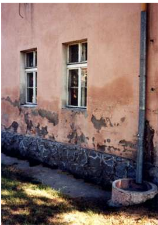
Фасад здания, пораженный грибком
